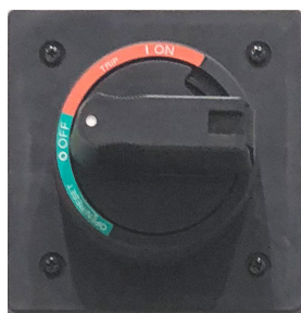
電源ブレーカ
